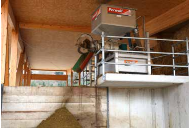
Der Gülleseparator trennt die angefallene Rindergülle in eine feste Phase und Dünngülle auf. Foto: Paula Pöchlauser-Kozel/LK NÖ
